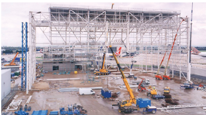
Стальная конструкция покрытия собирается на нижней отметке и поднимается на высоту с помощью домкратных рам
