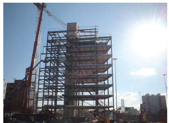
При возведении многоэтажных сооружений часто используются 35-метровые подъемники, достигающие восьмого этажа здания
