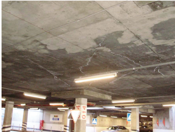
Рис. 12. Сквозные трещины в железобетонном перекрытии НМРА
